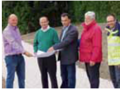
Beim Abnahmetermin der Kanalbauarbeiten (von links): Christian Wanner, Bürgermeister Martin Drexler, Stadtbaumeister Wolfgang Jaumann, Albert Eibl und Franz Mayer. Foto: Unflath
